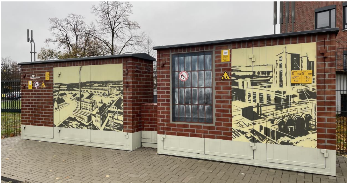
Gasübergabestation mit historischem Anklang an eine Werksansicht von 1902
