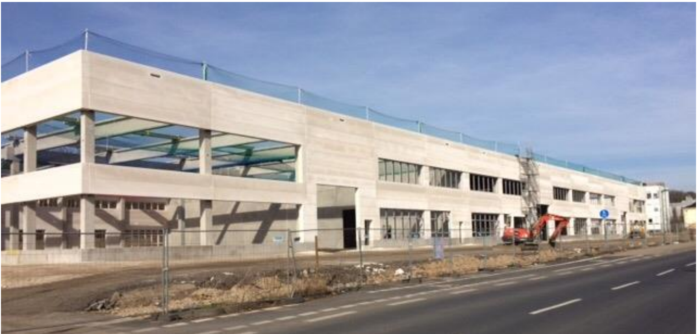
Gewerbehalle-Neubau, ca. 120x50x15 [m], Gierlichstr. 4, 53840 Troisdorf (von SO fotografiert) Foto: Dr. Volker Hofmann
