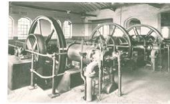
Ein Blick in den Maschinenraum des Aggerwerks
