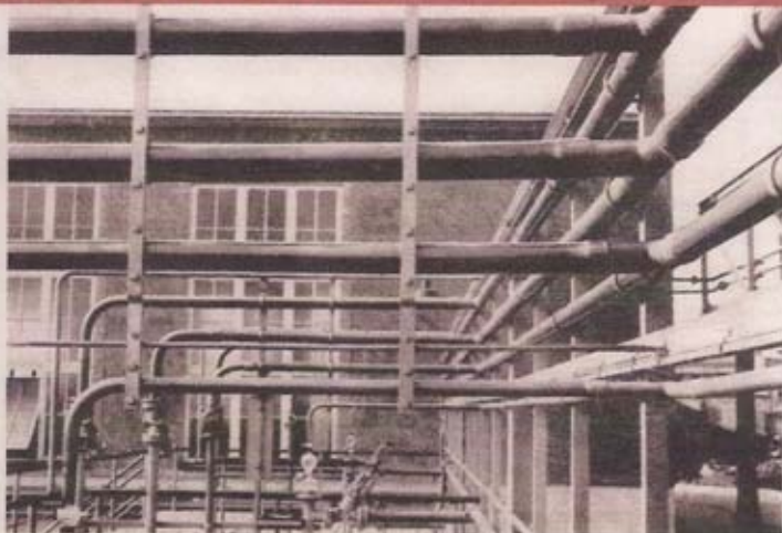
Bild 3. Im Freien verlegte „Vinidur“-Leitungen (Quelle: W. Kramrich)
