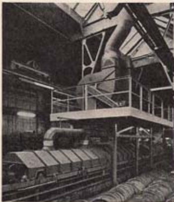
Bild 11 Entlüftungsanlage in einer Stahlbeize
