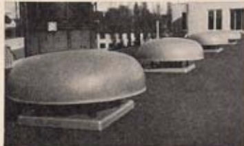
Bild 7 Hallenentlüftung mit Dach-Radialventilatoren
