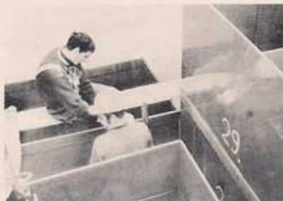
Bild 17: Abluftkanäle (PVC) Werkfoto REKU
