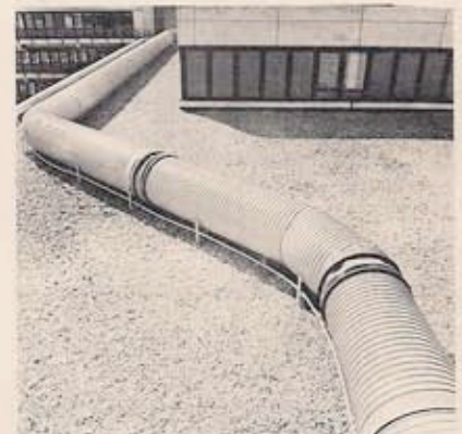
Bild 20: Sammelabluftleitung NW 1250 (TROVIDUR® Spiralrohr) Werkfoto DN
