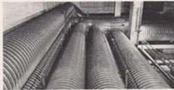
Abb. 32 Prozeßabluftleitungen DN 1000 aus Trovidur®-Spiralrohren
