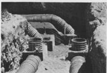
Abb. 26 3,5 m tiefer Absturz und 90° Richtungsänderung einer Doppelleitung DN 1000. Revisionsschächte ebenfalls DN 1000 sind als Festpunkt ausgebildet.
