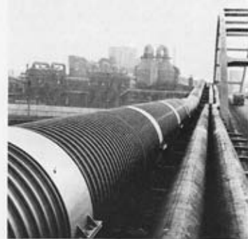
Abb. 13 Abluftleitung aus Trovidur Spiralrohren® DN 1400, K 3 für SO 2 -haltige Gase. Baujahr 1970, Unterdruck 4000 Pa.
