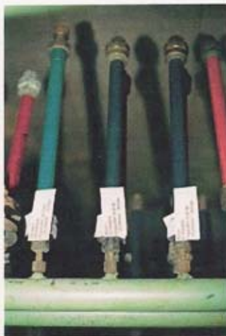
Seit rund 40 Jahren werden Kunststoffrohre einem Innendruck-Zeitstandsversuch unterworfen [14]
