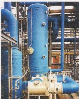
England, ETA Process Plant
